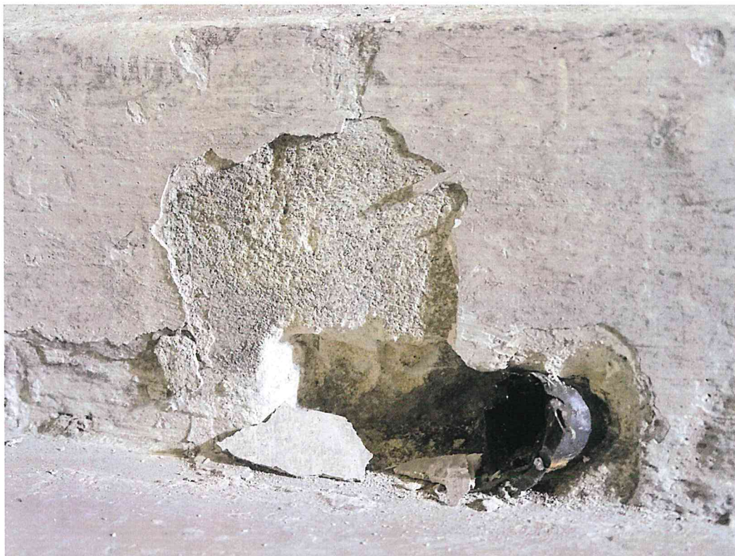
Ubytek kamienia w bocznej części predelli ołtarza głównego w kościele pw. św. Mikołaja w Lubaniu.
