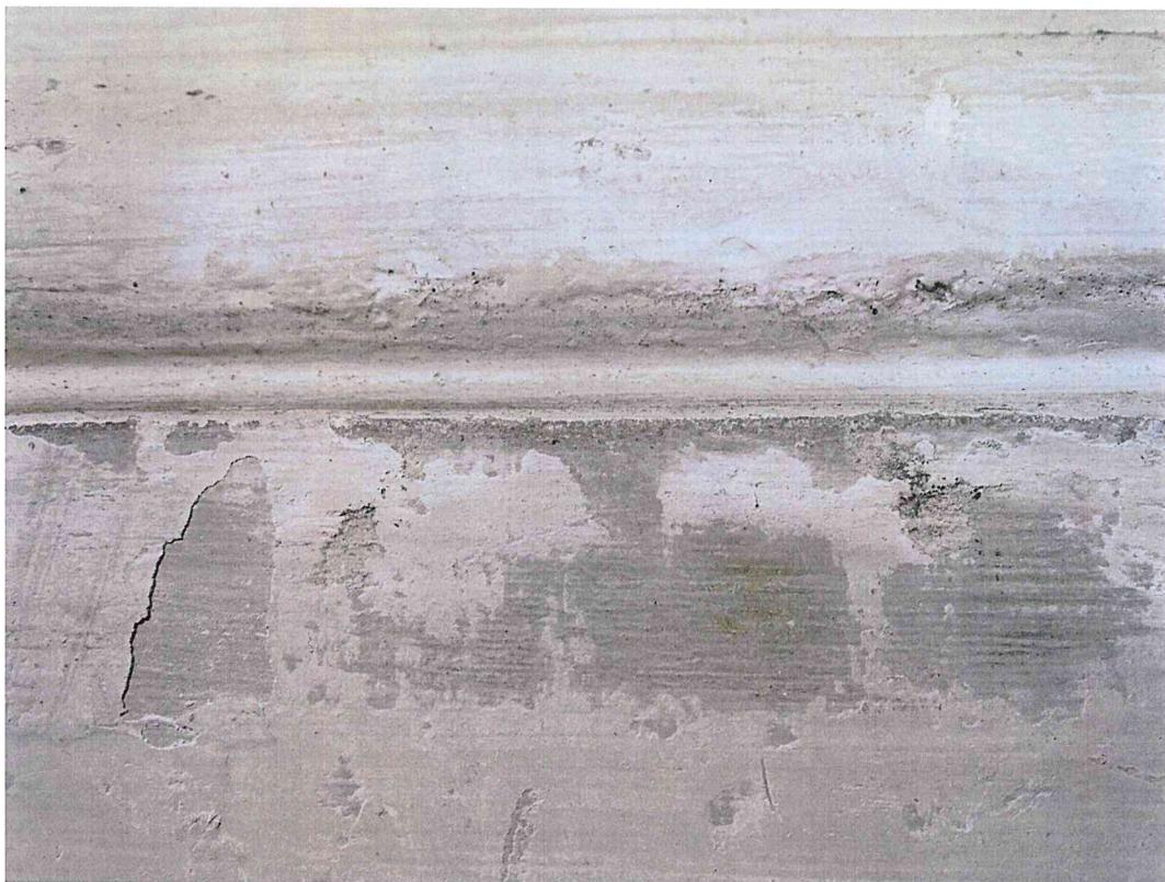
Złuszczające się warstwy wtórnych przemalowań na mencie.
